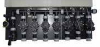
Basiseinheit mit 4 Stationen und Zuleitung Erweiterungseinheit mit 3 Stationen
